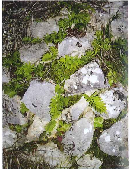
Les Polypodes colonisent le mur en pierres sèches situé au nord Le Col, Châteauneuf-Villevieille
