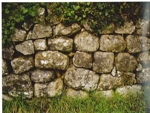
Joints linéaires générant des désordres Les Tourrettes, Châteauneuf-Villevieille
