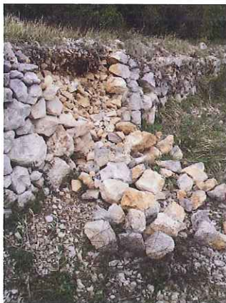
Ecoulement du mur de restanque Les Cabanes, Châteauneuf-Villevieille
