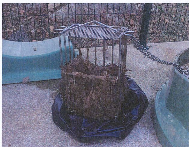
Déchets accumulés dans le réseau
